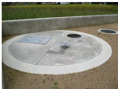
⑥ コンクリート製蓋
